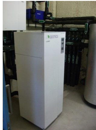
Sala de máquinas
