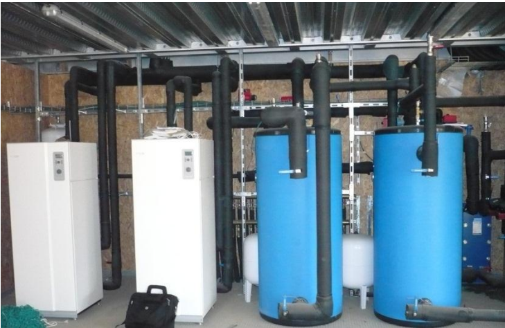
Sala de máquinas Schwartz Haumont
