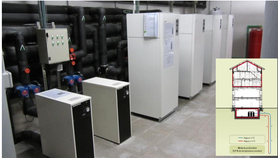
Vall de Núria, Edificio Sant Josep, interior sala de máquinas
