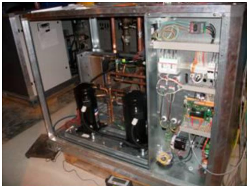
Bomba de calor geotèrmica
