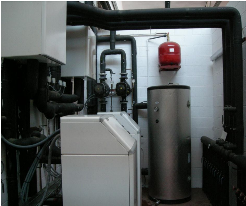
Sala de máquinas
