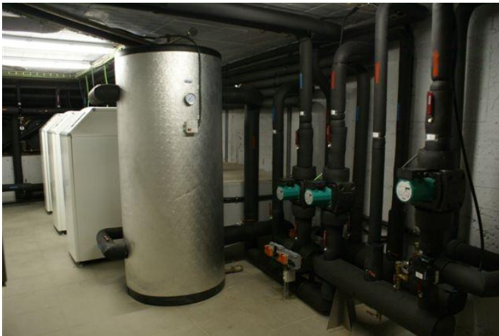
2008, hotel Dolcet, sala de máquinas
