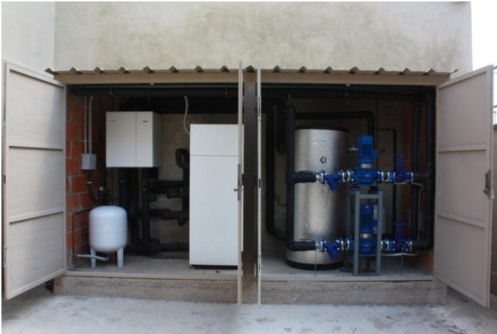
Sala de máquinas
