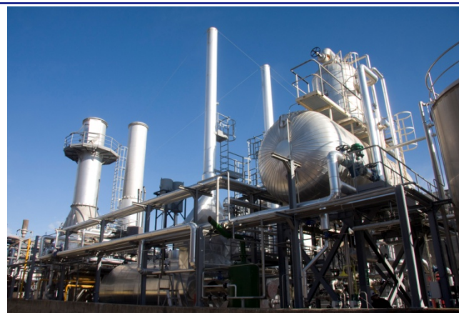
Planta de poligeneración en industria química Barcelona - España
