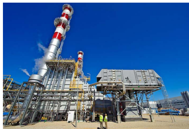
Planta de cogeneración en industria papelera Setúbal - Portugal
