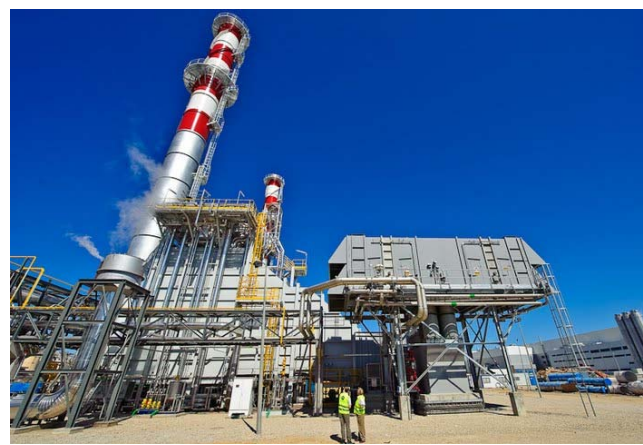
Planta de cogeneración en industria papelera Setúbal - Portugal
