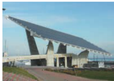
La pèrgola fotovoltaica del Fòrum
