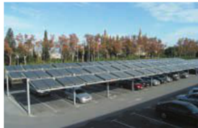
Central solar com a pèrgola d'un aparcament
