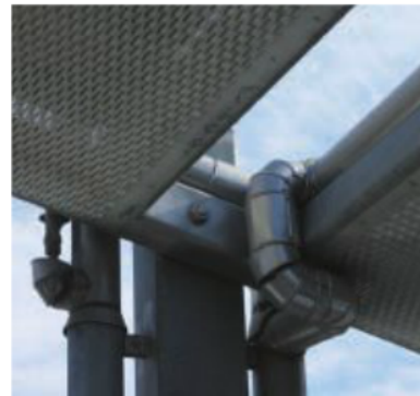
Detall d'una instal·lació solar
