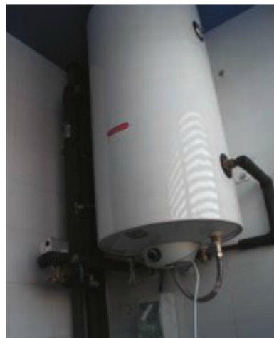
Escalfador elèctric de reforç
