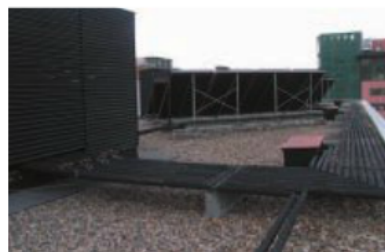
Instal·lació solar per ACS en un terrat
