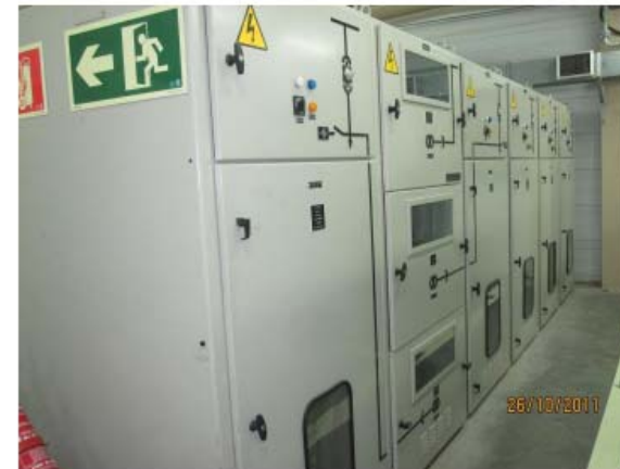
Figura 3-1 Bloque de cabinas que conforman la Barra 8A
