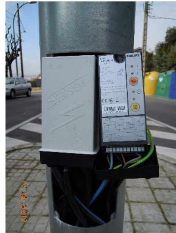
Actual PLL amb Telecontrol
